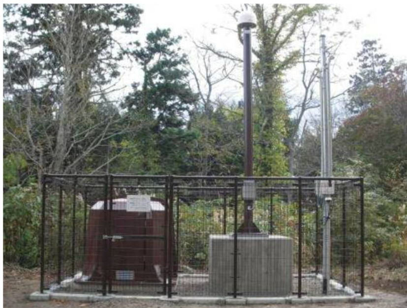
写真 1 恐山火山山頂部（湯坂）に設置した地震及び地殻変動の観測施設
